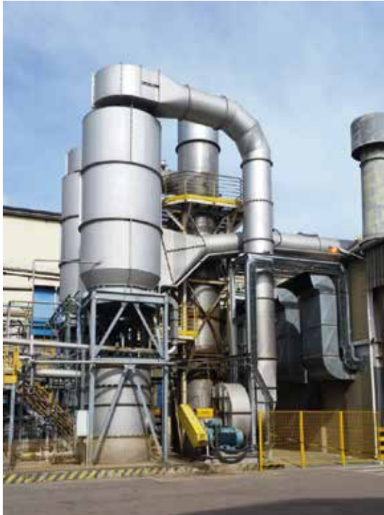
Lavador de Gases
