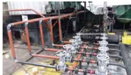
Sistemas Bombeamento/ Circulação
