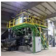
CALDEIRAS PARA GERAÇÃO DE VAPOR E ENERGIA
